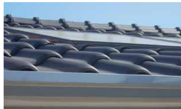
Il collettore solare VELUX risulta perfettamente integrato con la copertura. Nella foto sopra sono state utilizzate delle tegole aventi lo stesso colore del collettore VELUX.
